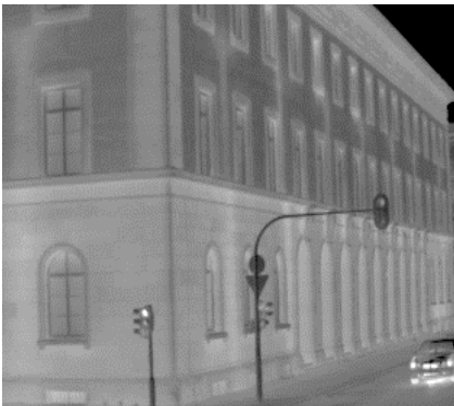
Abbildung 4: IR Aufnahme Süd-Ostfassade Hauptgebäude
